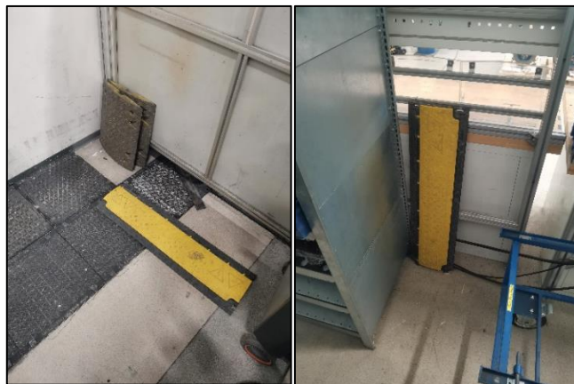
Obrázek 5: Náhodně rozmístěné přechody ke kabelům
